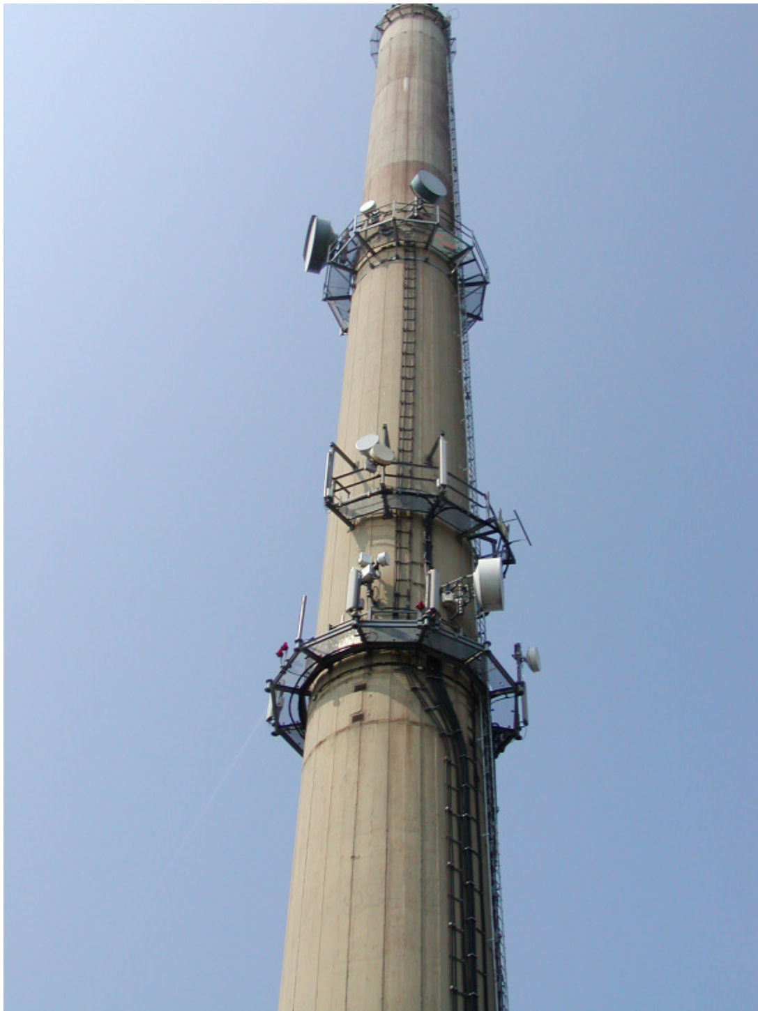
Stahlbetonschornstein MVA Stapelfeld mit Antennenanlagen und Kabeltrassen verschiedener Netzbetreiber, Höhe Schornstein 110 m
